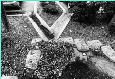
(Arriba) Hojas acumuladas, suciedad y astillas de corteza de árbol, obstruculan completamente esta rejilla de drenaje ubicada en el estacionamiento, impidiendo la corriente hacia la rejilla de entrada del conducto subterráneo.
