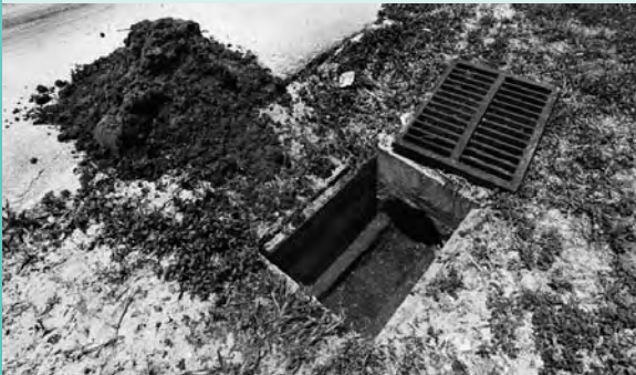
(Arriba): Es importante revisar debajo de las rejillas de drenaje para ver si hay acumulaciones de sedimento, basura o desechos. Las entradas a los conductos deben estar totalmente visibles y libres de cualquier tipo de obstrucción. (Centro): Llegando a este punto, siempre es más fácil y menos costoso quitar cualquier basura o acumulación ANTES de que esta sea transportada más lejos dentro del sistema de tuberías subterráneas. (Abajo): Quitar el exceso de sedimento permite que la estructura funcione con eficacia máxima. Recuerde desechar debidamente el exceso de material y colocar de nuevo con seguridad las rejillas de drenaje.
