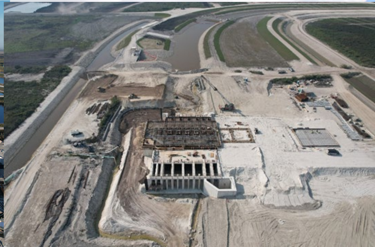
G-781 & STA Intake Channel
